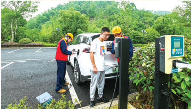
供电员工对径山村投运的远“杭”无忧充电桩进行“体检”
