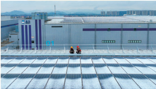
供电员工验收盒马供应链中心光伏项目
