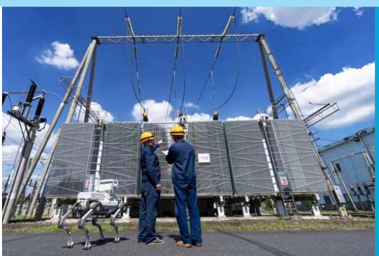
机器狗助力变电站巡检
