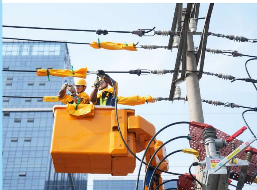
城西科创大走廊供电线路提升改造
