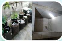
储水容器积水
