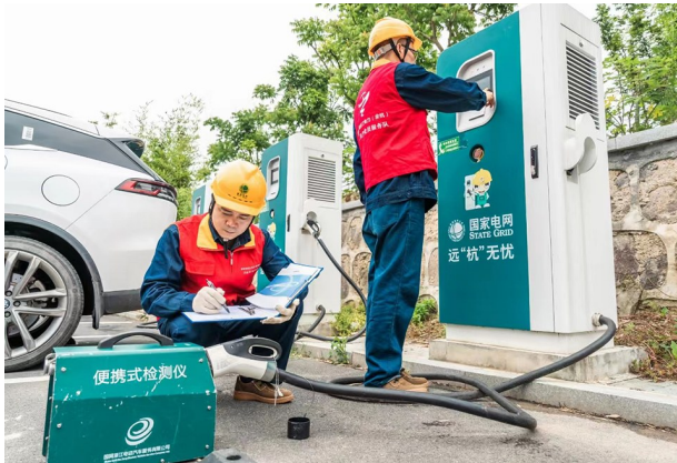
▲ 对充电桩进行巡检,保障车主充电需求
